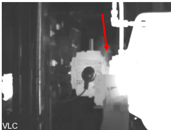
Bild 8: Gasleckage an der Dichtung einer Pumpe (IR-Bild-Modus)
