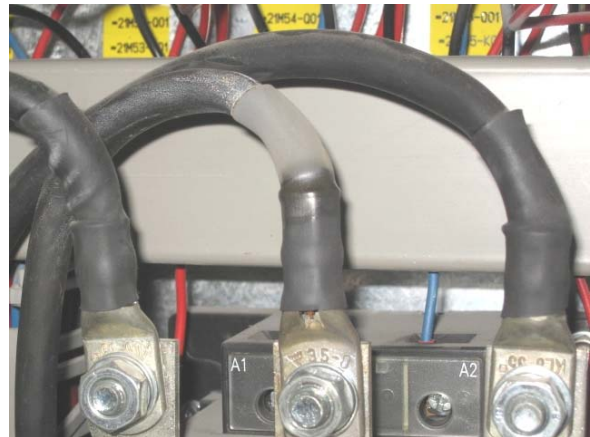
Bild 4: bereits optisch erkennbare Schädigung an einem Schützanschluss (Phase L2)
